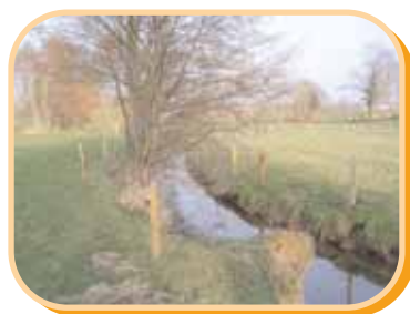
Photo: François RENAULT, travaux sur l'Oir Protection des berges grâce à la mise en place de clôture
