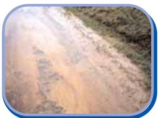
Sol "décapé" suite à une forte pluie coulant sur la route
